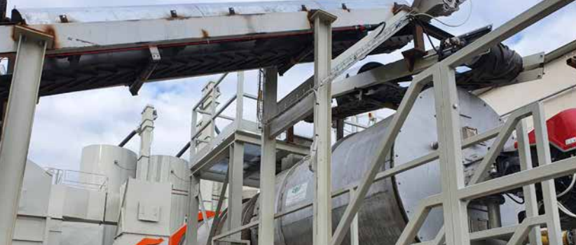
Impianto essiccazione Pomice / Pomice drying plant
