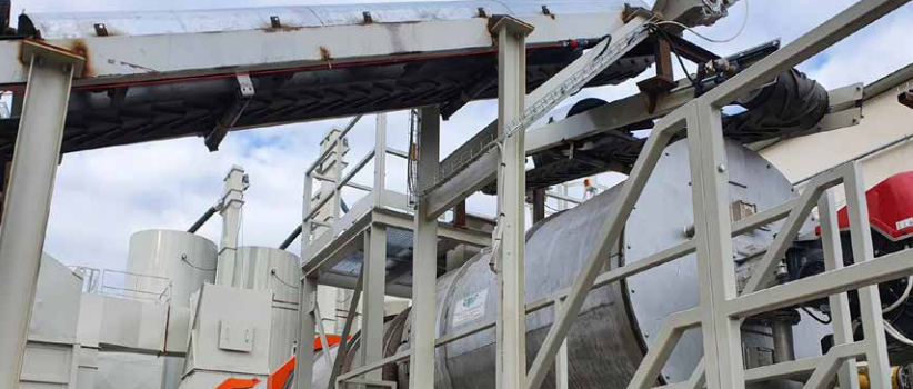
Impianto essiccazione Pomice / Pomice drying plant
