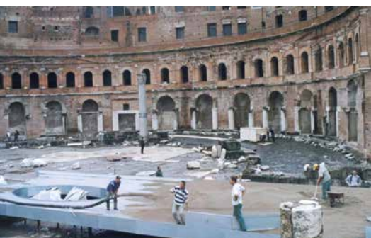
Riempimento leggero a base di Pomice Slight filling with Pumice Terme Traiano, ROMA
